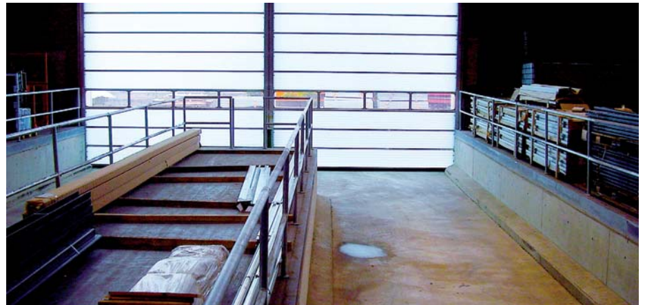
③ Neue Verladerrampen mit den neuen Rolltoren
